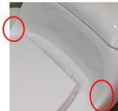
水箱前兩端凸出無法安裝
